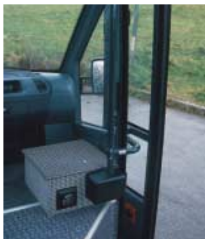
Wärmeluftheizung im Schatzkästchen: Bastellösung für die Innenraum-Heizung.
