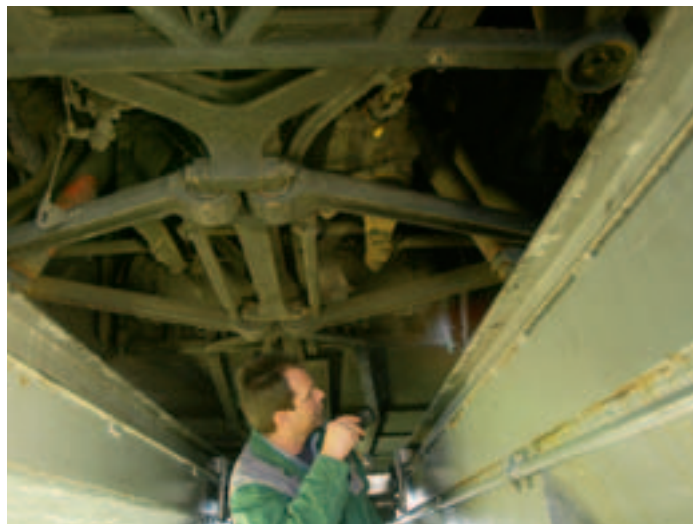
Ohne Beanstandung bleibt das Fahrwerk, der Unterbau ist nahezu frei von Korrosion.
