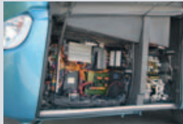
Das sehen Unfallsachverständige nicht gerne – die Elektrozentrale sitzt im meist gefährdeten Bereich.
