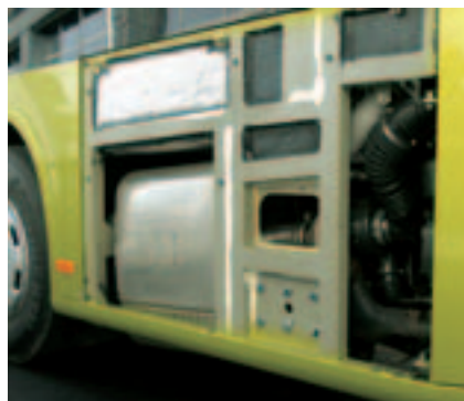
Hinter einer verschraubt-gesteckten Verkleidung der SCR-Kat im Schalldämpfer
