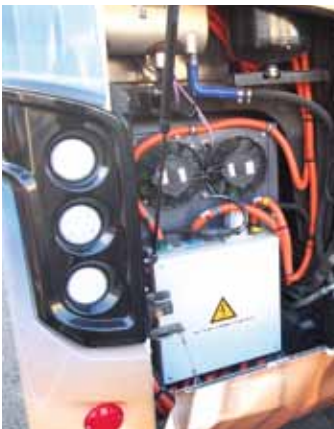
Im Heck: Anstelle des Dieselmotors sitzen Batterien und die Hochleistungselektronik unter der Haube.
